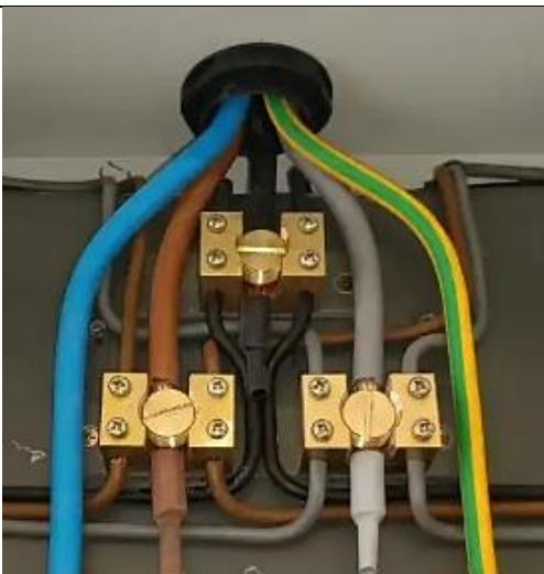
範例 31：✗ 引入線沒有正確地接駁(上下孖接)
