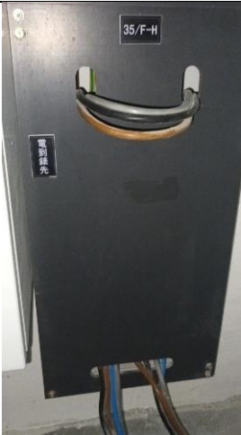
✓ 必須有「電到錶先」或「錶後掣」標示及單位識別標誌
