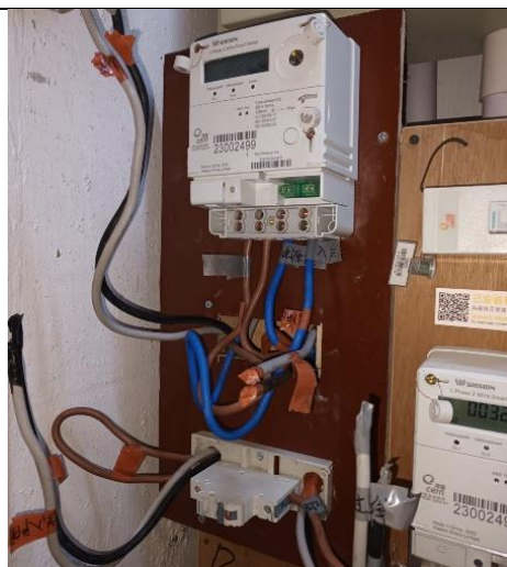
範例 18：✗ 錶位及電錶板未有安全固定
