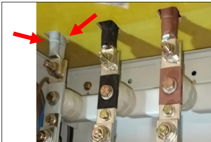
範例 23：✗ 電纜沒有正確地接駁 (孖接)
